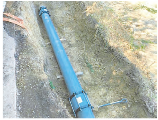
同左補修状況 塩化ビニル管 VUφ300mm
