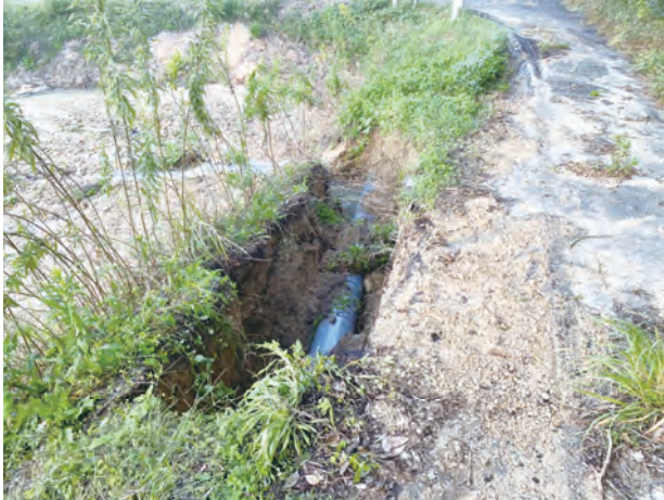
住吉支線漏水発生状況（常滑市） 塩化ビニル管 VUφ300mm
